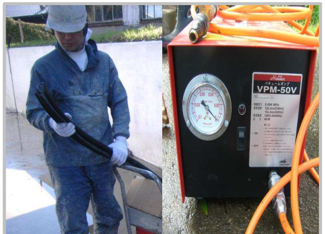
目地材吸引工(右:吸引ポンプ) (吸引ポンプによる目地材内空気の吸引)
